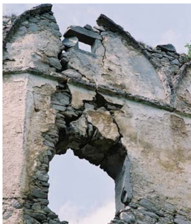
Atika a narušený záklenok pred zásahom.
