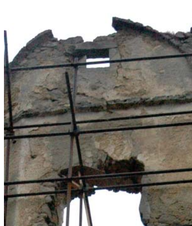
Ten istý záklenok a atika po zásahu.
