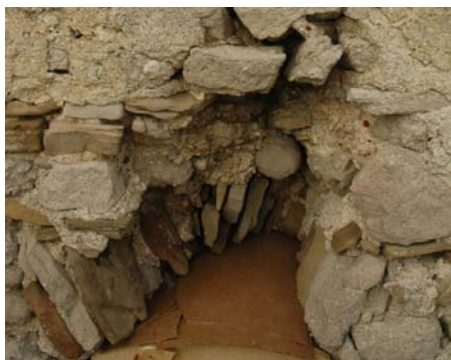
Narušený záklenok prvého poschodia
